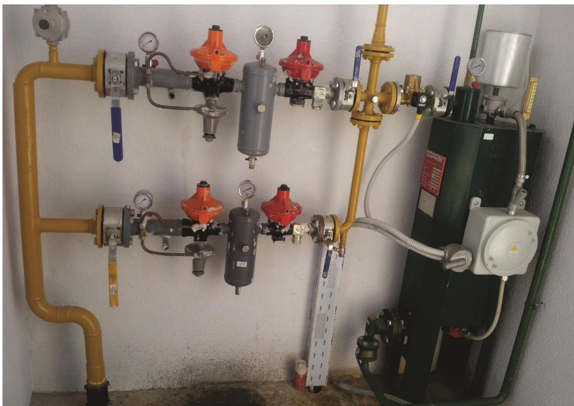
Plinska stanica u na graničnom prijelazu ZVIRIĆI Isparivačko regulaciona stanica kapaciteta 50 kg/h, sa 3 skaldišna rezervoara kapaciteta 4980 l Godina izgradnje 2012
