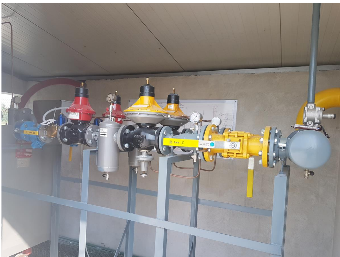
Plinska stanica u firmi FERETTO GROUP u Usori Isparivačko regulaciona stanica kapaciteta 400 kg/h, sa uzemnim skaldišnim rezervoarem kapaciteta 62 m 3 Godina izgradnje 2018.
