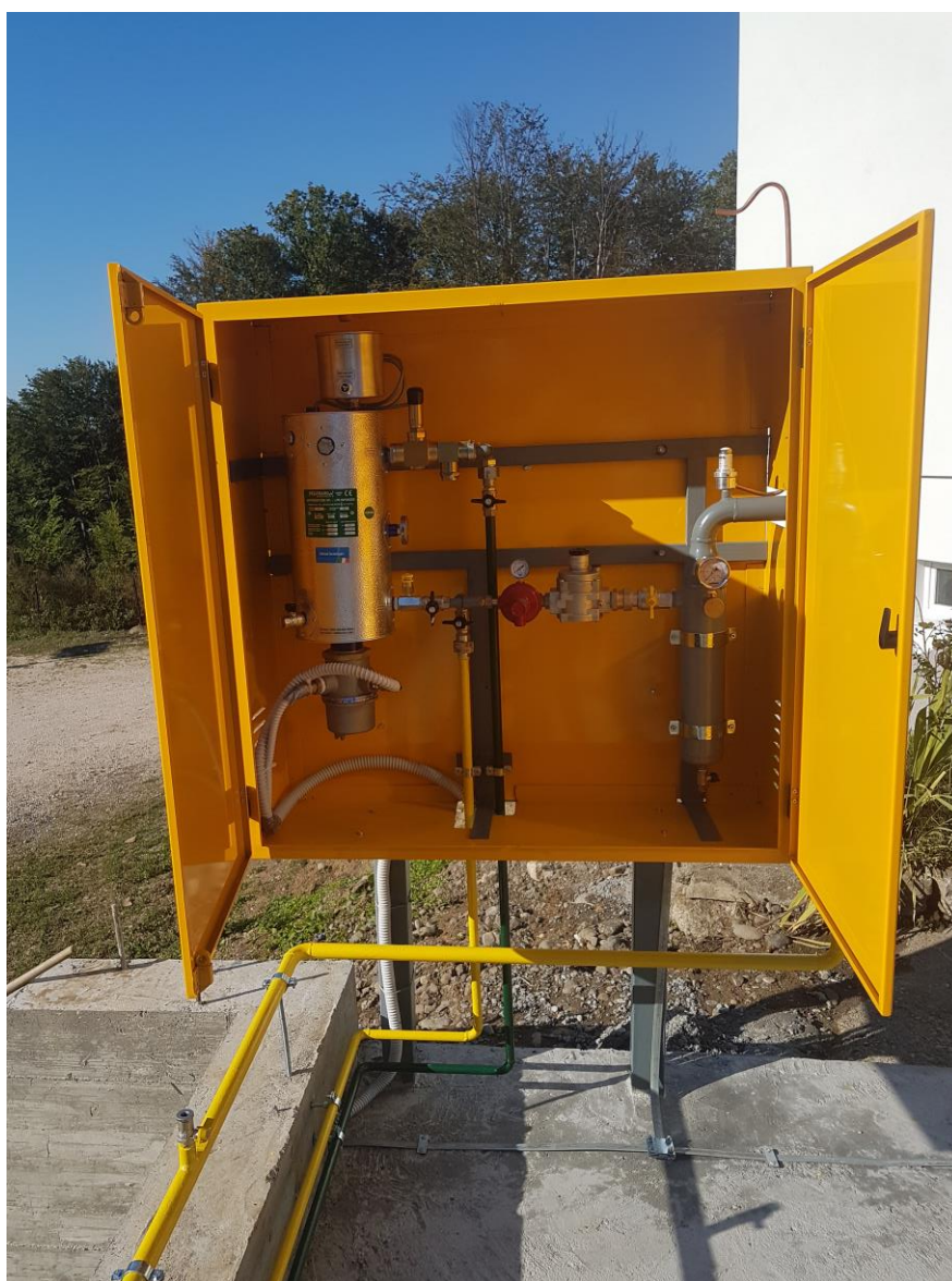
Plinska stanica Domu zdravlja u Usori Isparivačko regulaciona stanica kapaciteta 40 kg/h, sa skaldišnim rezervoarem kapaciteta po 4,98 m 3 . Godina izgradnje 2018.
