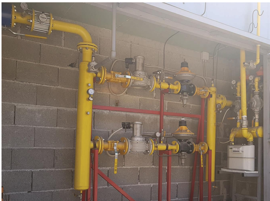
Plinska stanica u u firmi SurTec Konjic Isparivačko regulaciona stanica kapaciteta 2x200 kg/h, sa 2 skaldišna rezervoara kapaciteta 60 m3 Godina izgradnje 2015
