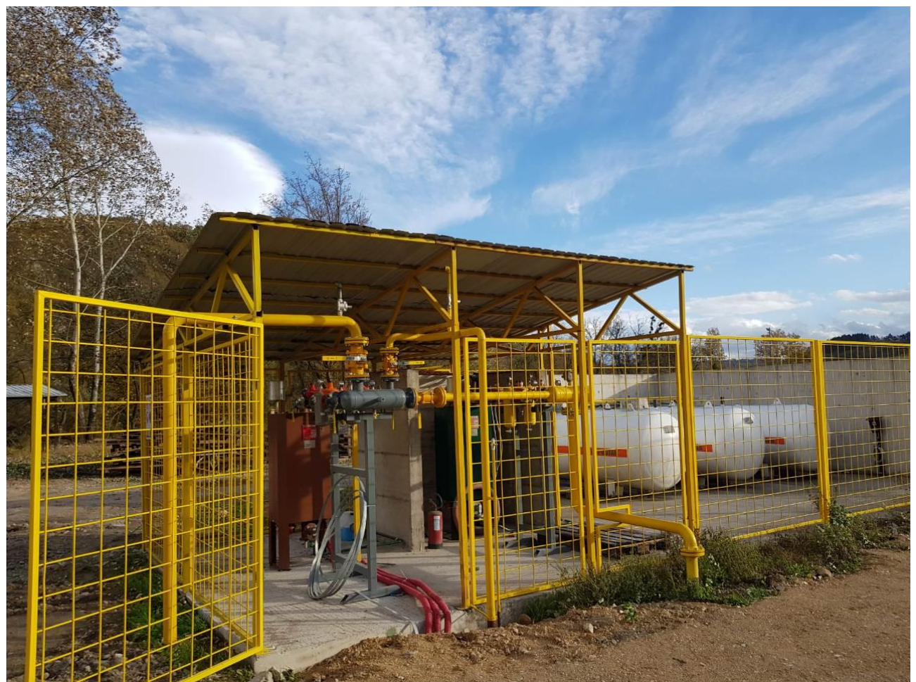
Plinska stanica u firmi BOSANKAR doo Bosanska Krupa Isparivačko regulaciona stanica kapaciteta 2 x 200 kg/h, sa 3 skaldišna rezervoara kapaciteta 4,95 m 3 Godina izgradnje prve faze 2016, godina izgradnje druge faze 2019.
