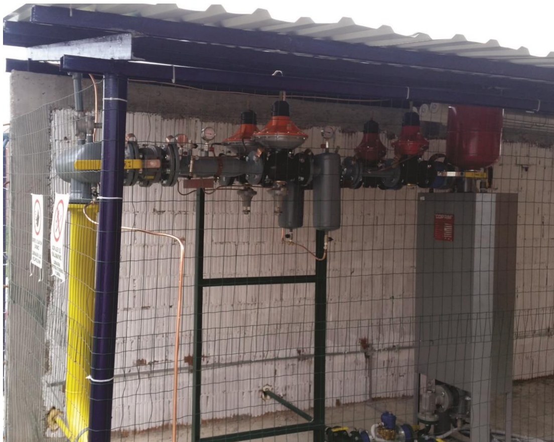
Plinska stanica u firmi Bioil Kotorsko Isparivačko regulaciona stanica kapaciteta 500 kg/h, sa 2 skaldišna rezervoara kapaciteta 4,85 m 3 Godina izgradnje 2016
