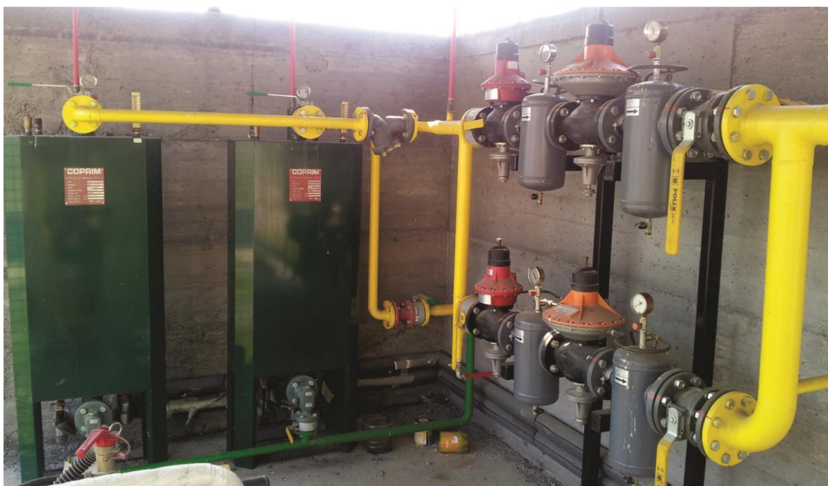
Plinaka stanica AD POLJOPRIVREDNIK u Derventi, Isparivačko –regulaciona stanica kapaciteta 300 kg/h sa 2 skladišna rezervoara od 60 m 3 Godina izgradnje 2010
