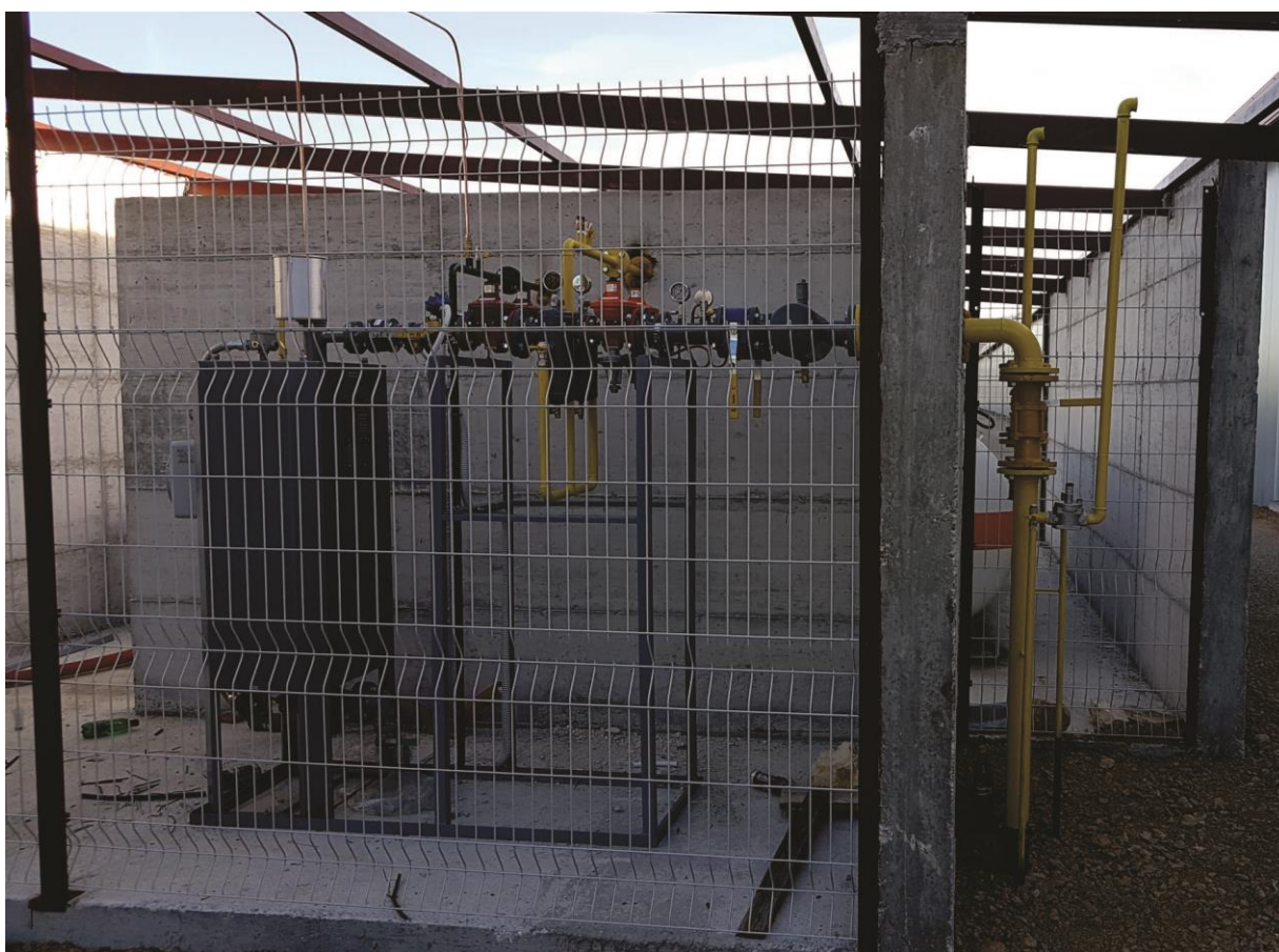
Plinska stanica u firmi PAVIĆ doo Livno Isparivačko regulaciona stanica kapaciteta 150 kg/h, sa 3 skaldišna rezervoara kapaciteta 4980 l Godina izgradnje 2017
